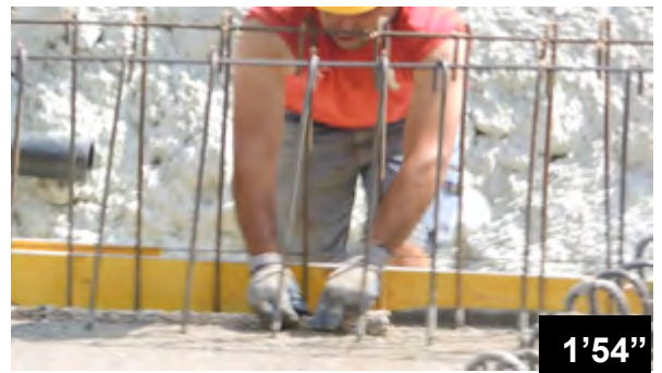
Incorporation des bandes BFL-Mastix 20/40 R4 dans le béton frais d'un ra- dier
