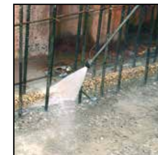
Zur Verbesserung der Rauigkeit der Arbeitsfuge und der Haftung mit dem frischen Beton, ist die Arbeitsfuge mit Hochdruc- kwasserstrahl (Kärcher) zu behandeln.
